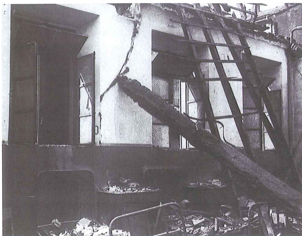
13 Agosto 1943 - Il dormitorio del Pensionato dopo il bombardamento.
